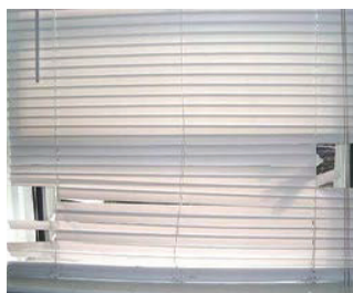
Missing or broken slats
